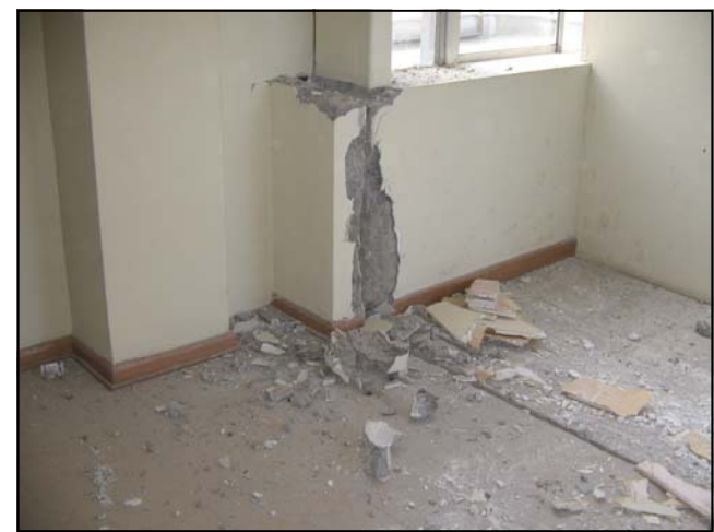
Daños en el sector del Aula Magna y en el hall central del Pabellón G
