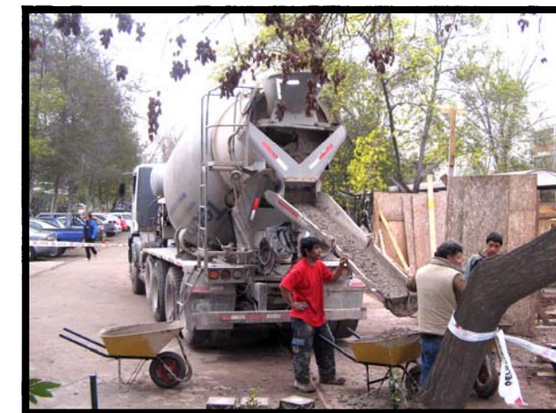
A toda máquina se trabaja en la obra gruesa de esta nueva infraestructura para la Facultad de Ciencias
